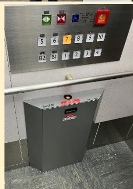
エレベーター閉じ込め様に備蓄キットも配備された。
