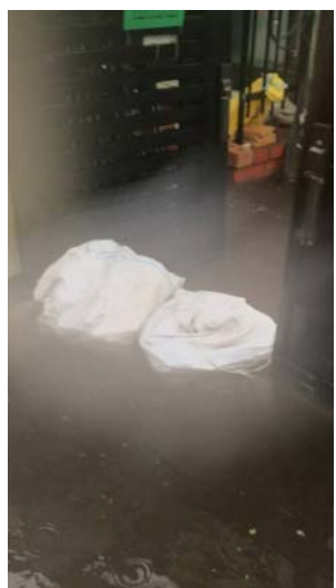
土のうを越える浸水になった。土のうの設置や小型排水ポンプの設置では対処しきれない状況となっている。
